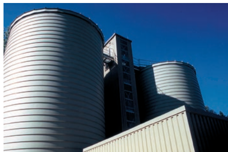
Bild 2: Zweistufige Hochleistungsanlage zur Vergärung von Klärschlamm in Leonberg. Figure 2: Two-stage high-performance plant for sewage sludge digestion, at Leonberg (Germany).
