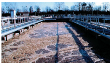
Bild 1: Belebungsbecken einer Kläranlage. Das Fraunhofer IGB optimiert und erweitert bestehende Abwasserreinigungsanlagen nach systematischer Analyse und spezifischen Messungen.
